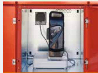
Schließfach mit Schuko-Steckdose für den Betrieb von bauseitigen Ladestationen.
