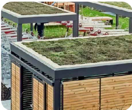
↑ Dachbegrünung Die Extensive Dachbegrünung besteht aus Drainage- und Wasserspeicherplatten, Qualitätsvlies, Substrat nach FLL Richtlinie, Kies, Vegetationsmatte mit verschiedenen Sedumarten.
